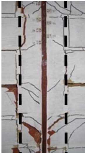
(d) Perpend Shear failure
